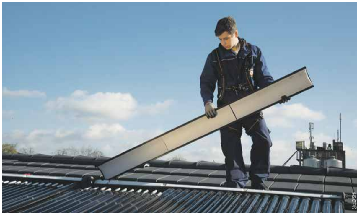
Bei thermischen Solaranlagen können in der Praxis schnell Fehler passieren.
