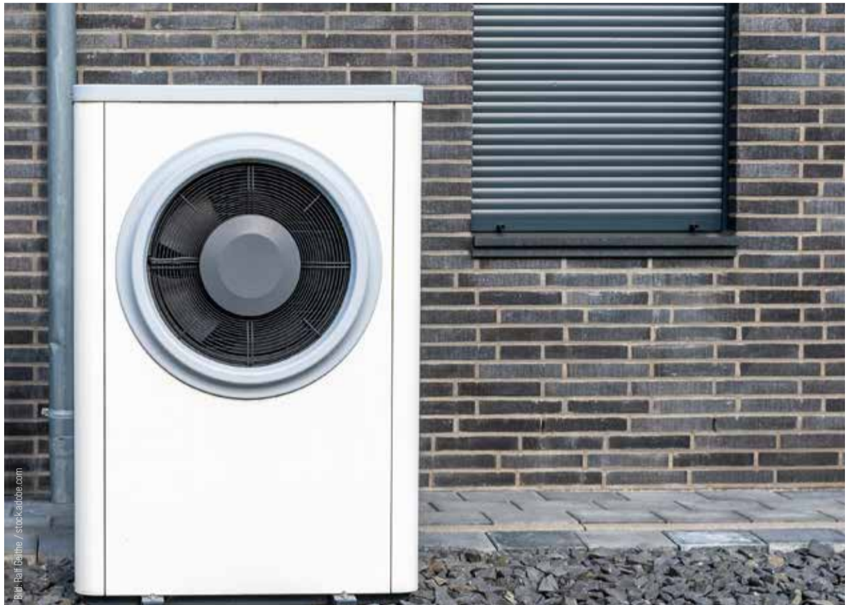
Im Gegensatz zur Inbetriebnahme von Gas- und Öl-Geräten sind bei der Wärmepumpe sehr viele Einstellungen zu beachten.
