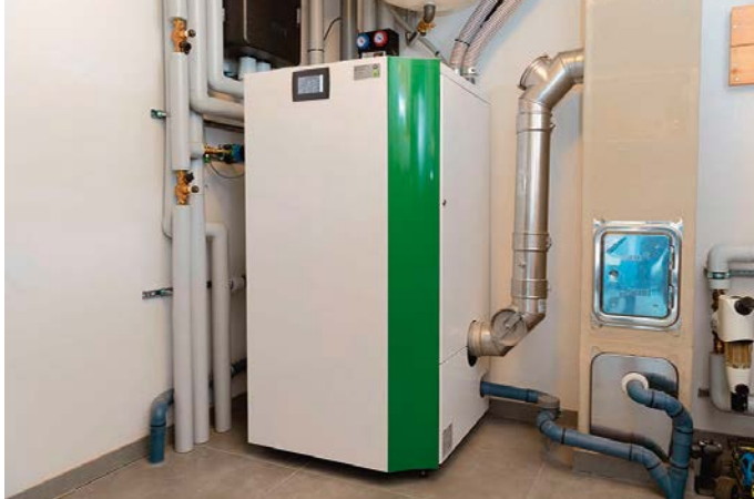
Der hochmoderne Pelletkessel arbeitet sehr sauber. Eine zusätzliche Filteranlage ist nicht nötig.
