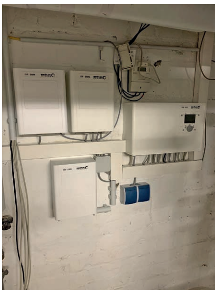
Montage einer ISR-Solarregelung des Herstellers Brötje sowie eines Wärmemengenzählers für den Kollektorkreis.
