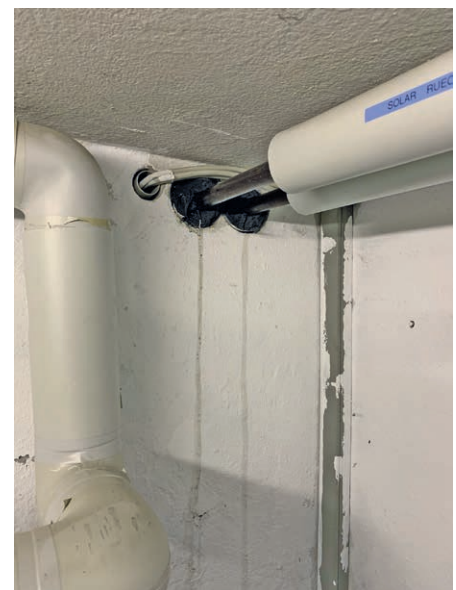
Undichtigkeit zweier Solar-Steigeleitungen durch grundlegende Installationsfehler – Austritt von Solarflüssigkeiten aus dem Rohrschacht.
