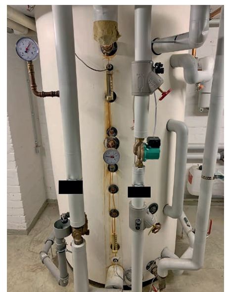
Mehrfach durch Installationsfehler undichter Solarspeicher kurz nach Ablauf der Gewährleistungsfrist.
