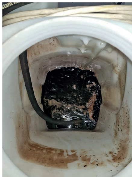
Stark verbrauchte Solarflüssigkeit – Aufnahme von Zersetzungsprodukten und Schwebstoffen – kein Frostschutz mehr gegeben.
