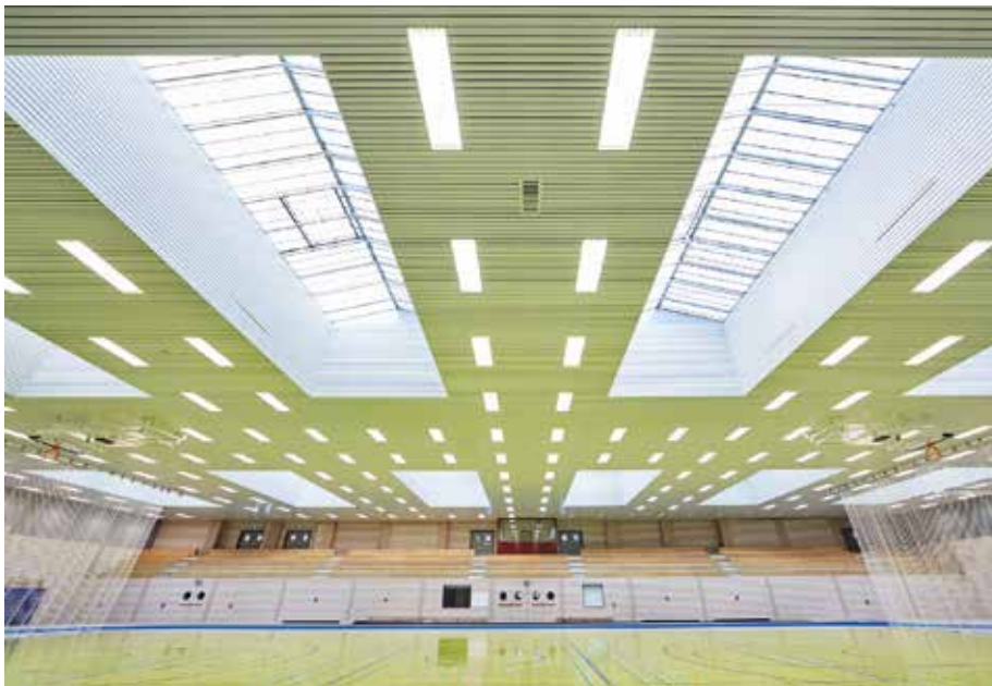
Abbildung 4: Deckenstrahlheizungen sind Funktionsträger, Einbauleuchten können einfach integriert werden. Die Ballwurfsicherheit im System mit Beleuchtung ist bestätigt.
