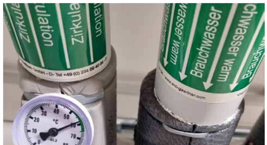
Abbildung 4: Das definierte Temperaturfenster von 60/55°C ist in Trinkwasserinstallationen präventiv geeignet, das Wachstum von Legionellen zu unterbinden – mehr nicht.
