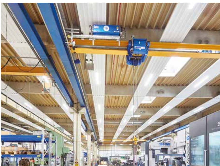
Sprinkleranlagen oder Krananlagen lassen sich gut mit Deckenstrahlplatten kombinieren.
