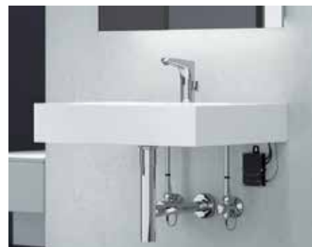
Abbildung 2: Mit Temperatursensoren lassen sich kritische Temperaturbereiche erkennen und managen, bevor sich Legionellen übermäßig vermehren können.
